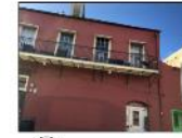
M) DUMAINE STREET [7][8] STRING LIGHTS / WIRING / CONDUIT
